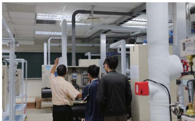
冷凍空調裝修技能檢定考場
