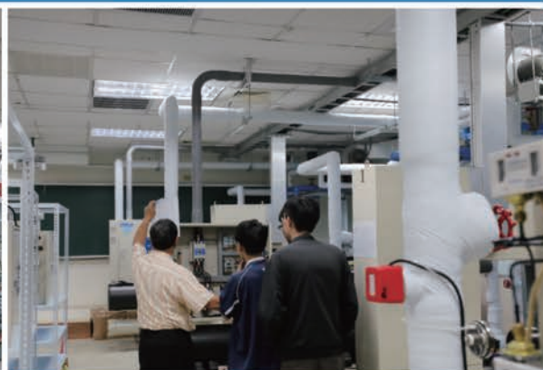
冷凍空調裝修技能檢定考場
